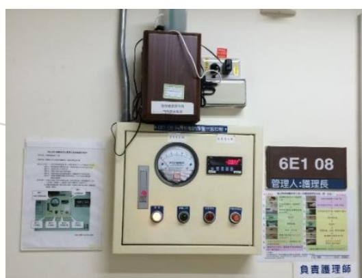
圖 4. 負壓隔離病房空調系統，指針式與數字式氣壓表並存，控制盤上方為外接警示喇叭
